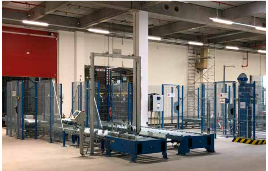
Im 2. OG baute Kardex Mlog die den Vertikalumsetzern nachfolgende Fördertechnik komplett neu auf.
