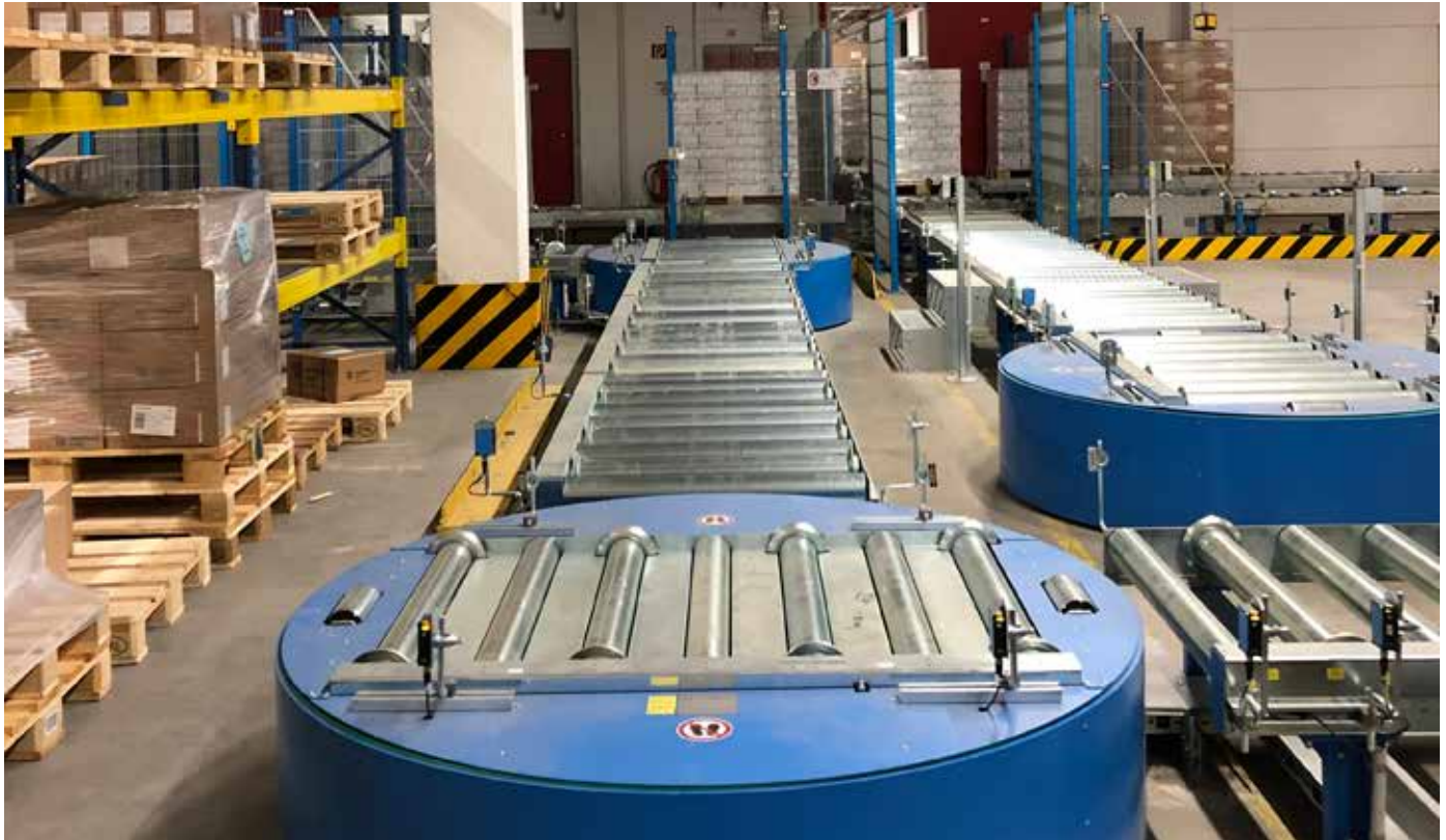
Im Erdgeschoss wurden Drehtische zur Anbindung der bestehenden Förderanlage an das Hochregallager integriert.
